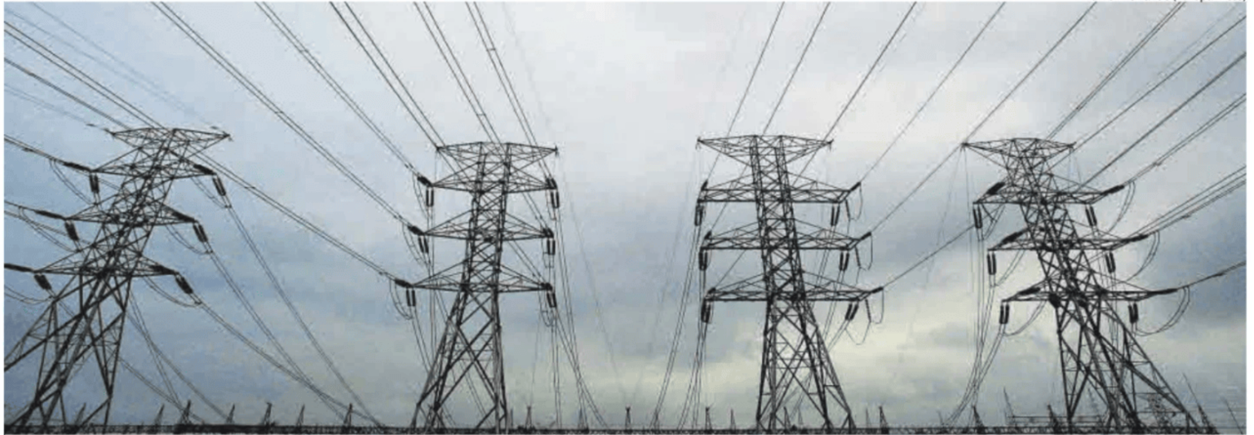
Líneas y torres de alta tensión.
