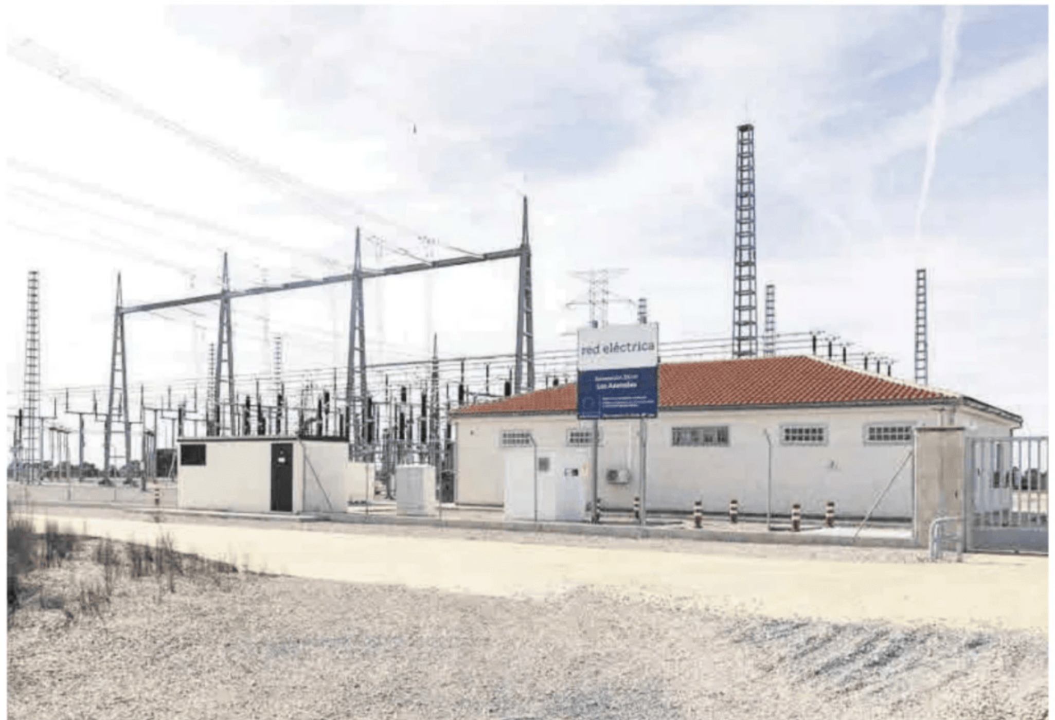
Nueva subestación en Los Arenales para reforzar el suministro en la provincia de Cáceres.
